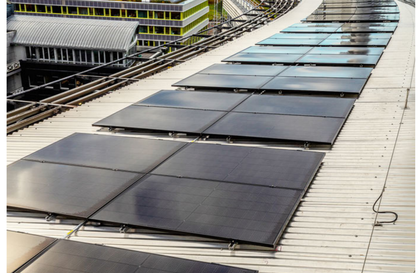
Der Strom, den die Photovoltaikanlage auf dem Dach des GVZ-Hauptsitzes produziert, dient unter anderem der Versorgung der sieben GVZ-Elektrofahrzeuge.
