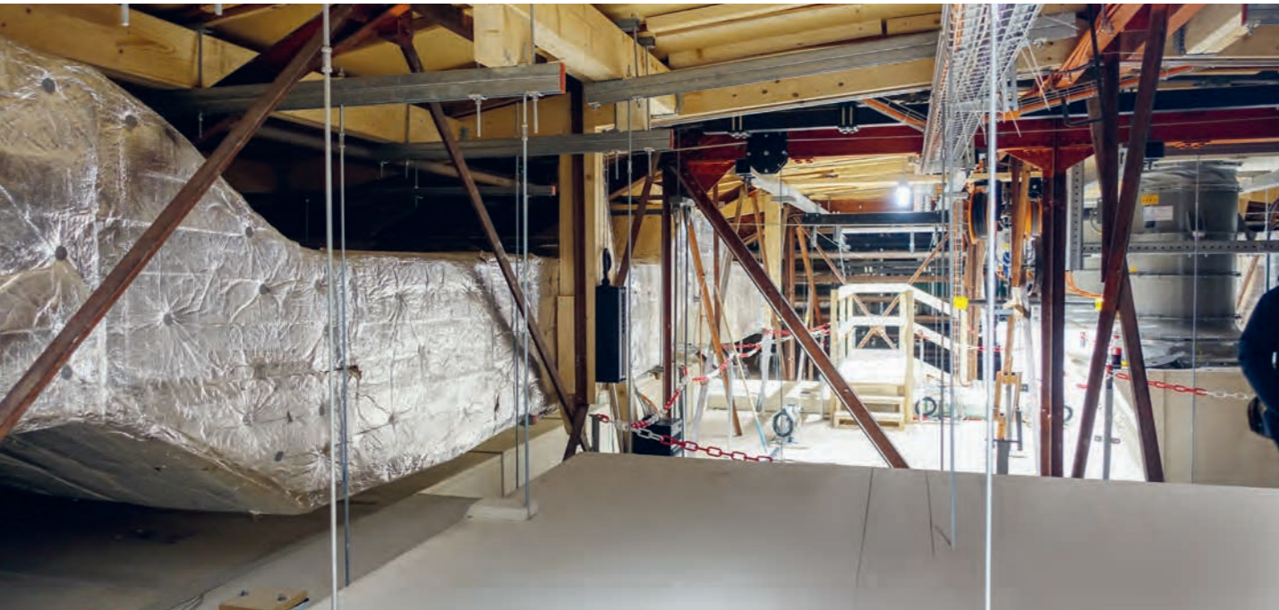
Blick in den Dachstuhl der Tonhalle Zürich: Entrauchungskanal für die Maschinelle Rauch- und Wärmeabzugsanlage (unten) sowie der Abluftkanal (links)
