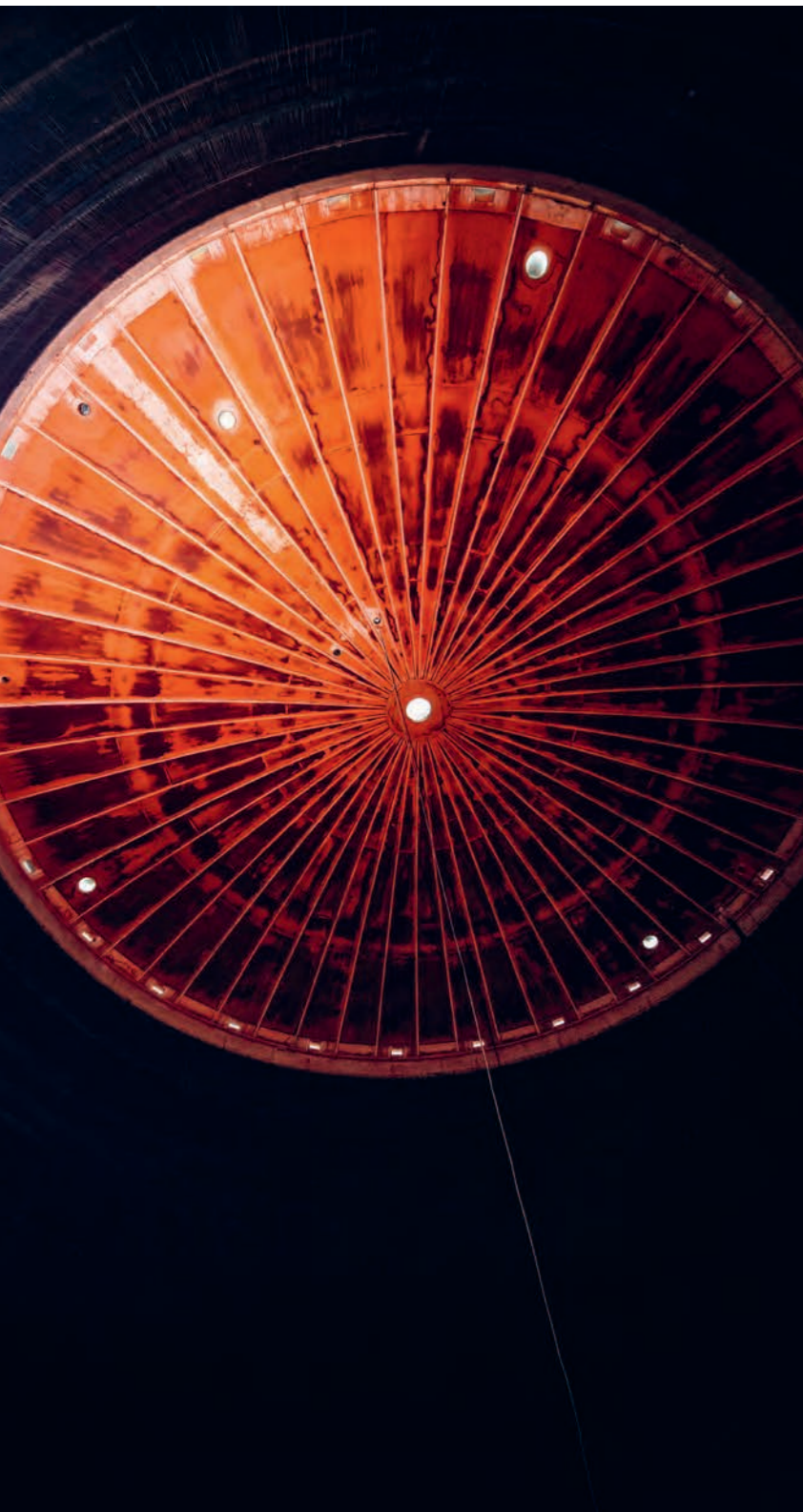
Tankanlage Rümlang AG, ein Blick in einen leeren Tanksilo
