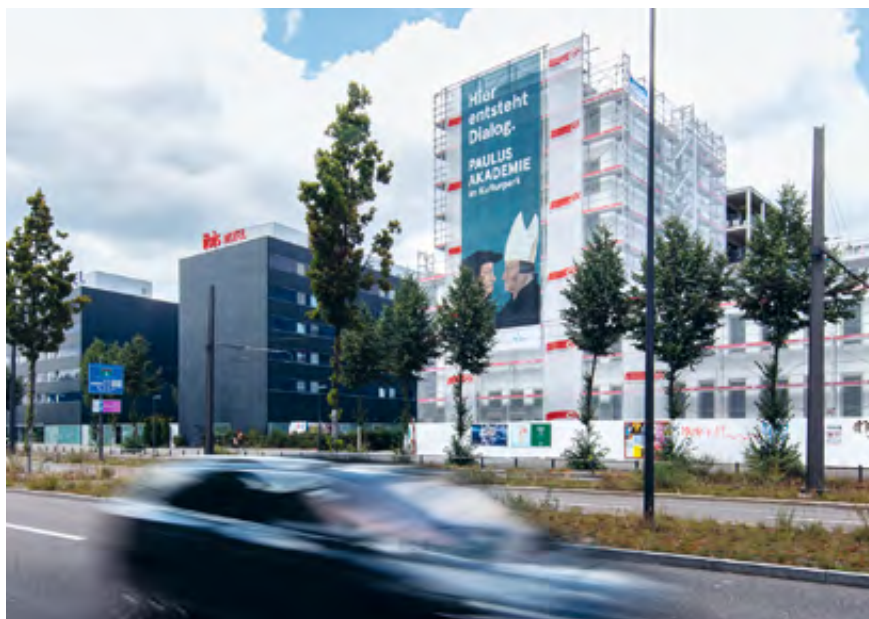
Ein Grossplakat über die ganze Fassade mit den Profilen von Zwingli und einem Bischof kündigt an, welcher Wind im neuen Gebäude der Paulus Akademie wehen wird: «Hier entsteht Dialog». Foto: Peter Knup
