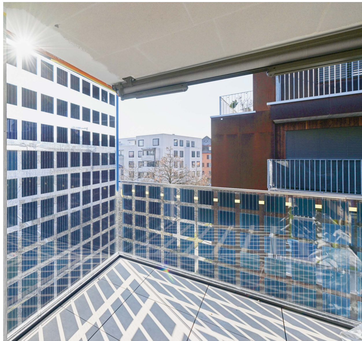
Photovoltaik-Anlage Neubau Dörflistrasse 11
